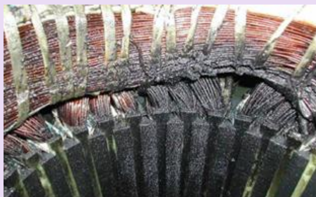
б) перегрев обмотки статора
